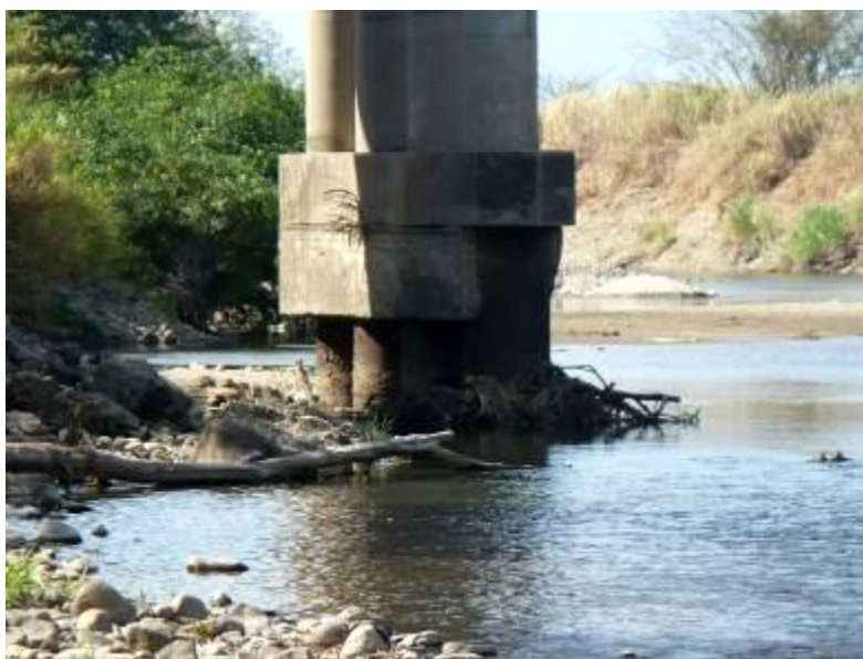
Foto 9: Base erosionada del puente sobre la Interamericana.
